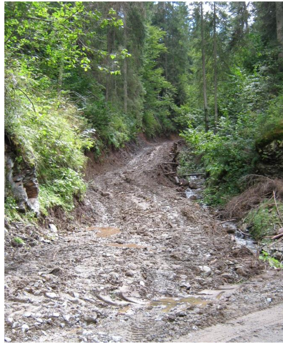
Fig. 8 Chemin forestier et l'apparition d'une ornière sur celui-ci à la Vallée de Măriilor
