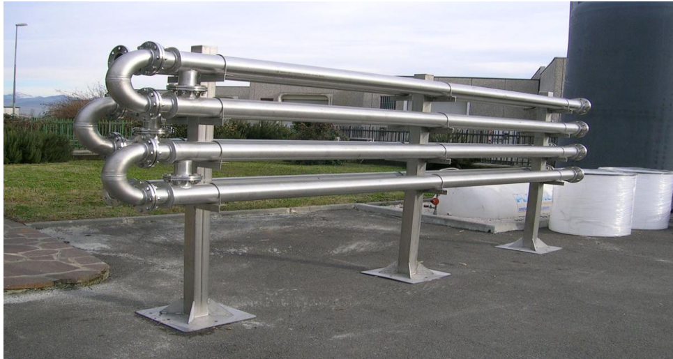
Figura 1 Schimbator de caldura la Statia de epurare Cluj-Napoca
