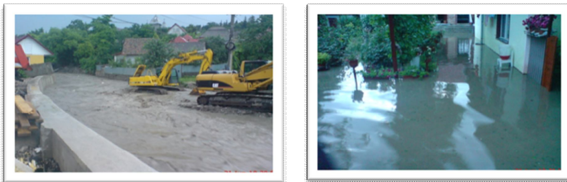
Fig.15. Revărsarea Pârâului Valea Racilor, însoțită de inundații pluviale, în iunie 2010
