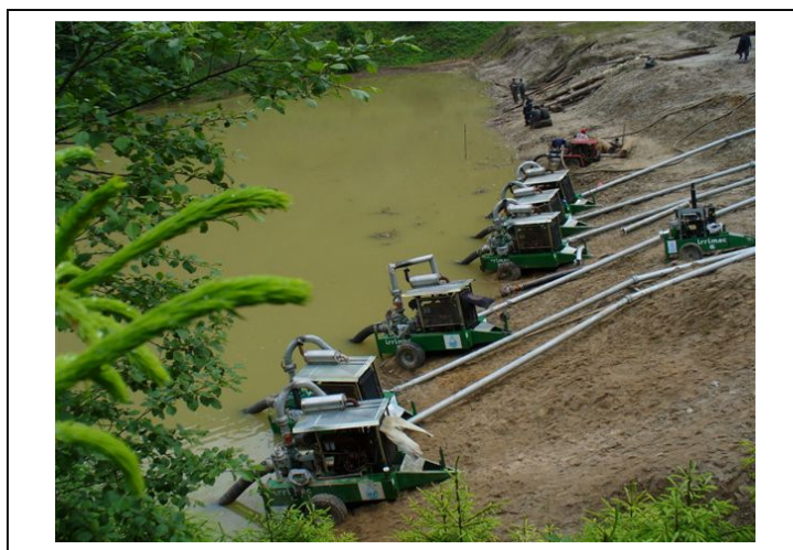
Fig. 13 Măsurile de diminuare a riscului de cedare a iazului Târnicioara ca urmare a acumulării de ape de precipitație
