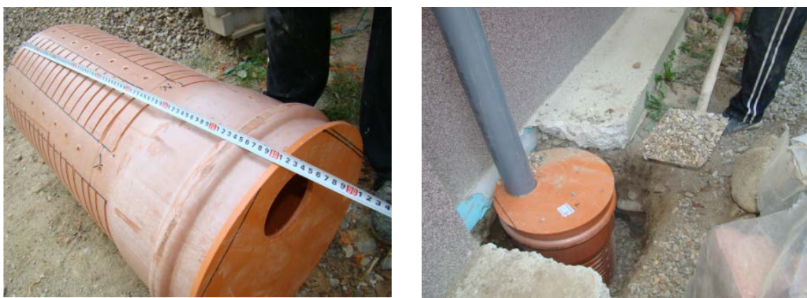
Fig.3.2. Colectorul de radon, tub gros PVC, cu diametru de 40 cm și lungime de 80 cm, prevăzut cu fante și găuri de trecere a gazului radon (stânga) și colectorul de gaz de radon introdus în fundația casei, prelungit cu un tub lung PVC, fixat pe pereții exteriori ai clădirii (dreapta) (original).
