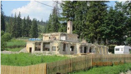
d. Clădire concesionată și demolată parțial de către primărie
