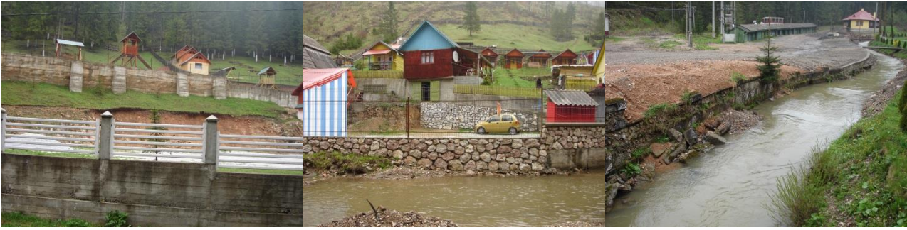
Figura 12.a. Construirea în trepte, consolidate cu pereți de beton b. Unitate de cazare turistică aflată pe valea Pârâul Oii c. Maluri consolidate dealungul Biczului
